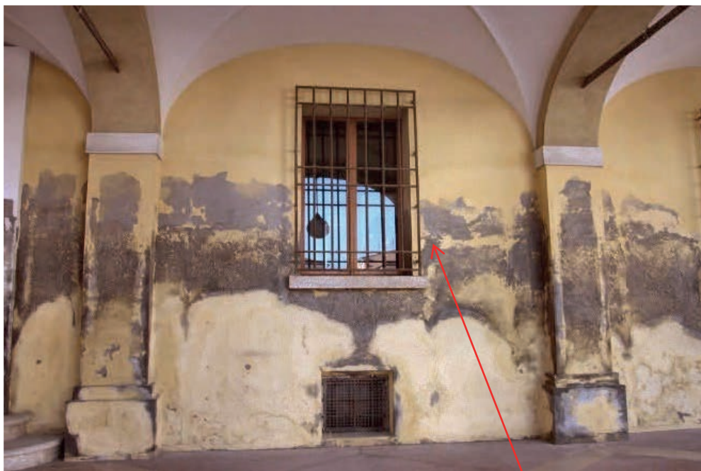
Cervia (RA) – piazza Giuseppe Garibaldi: murature soggette a patologie provocate da umidità di risalita capillare e dalla conseguente presenza di sali.
