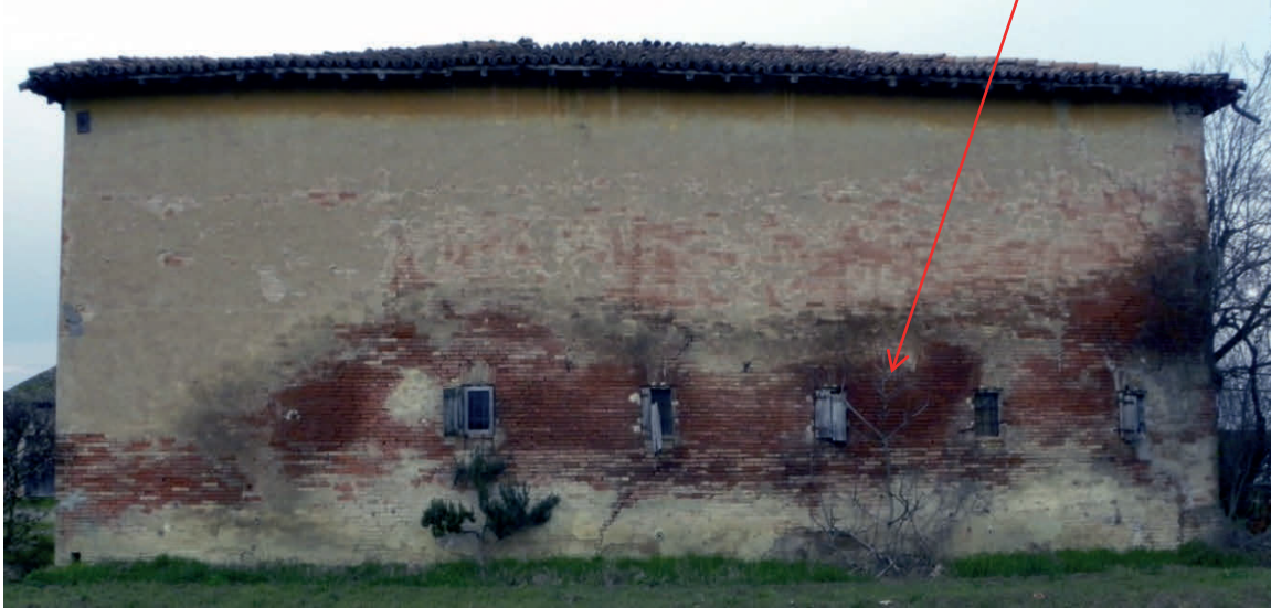
Carpi (MO) – edificio rurale, un tempo adibito a stalla: sono evidenti la forte presenza di umidità da risalita e di sali igroscopici, in prevalenza nitrati
