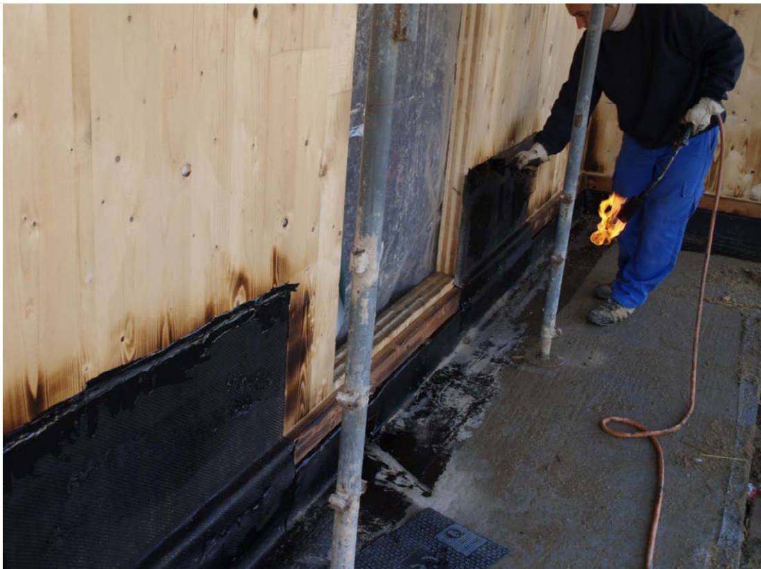
Posa telo di guaina catramata per i primi 60 cm. a protezione umidità
