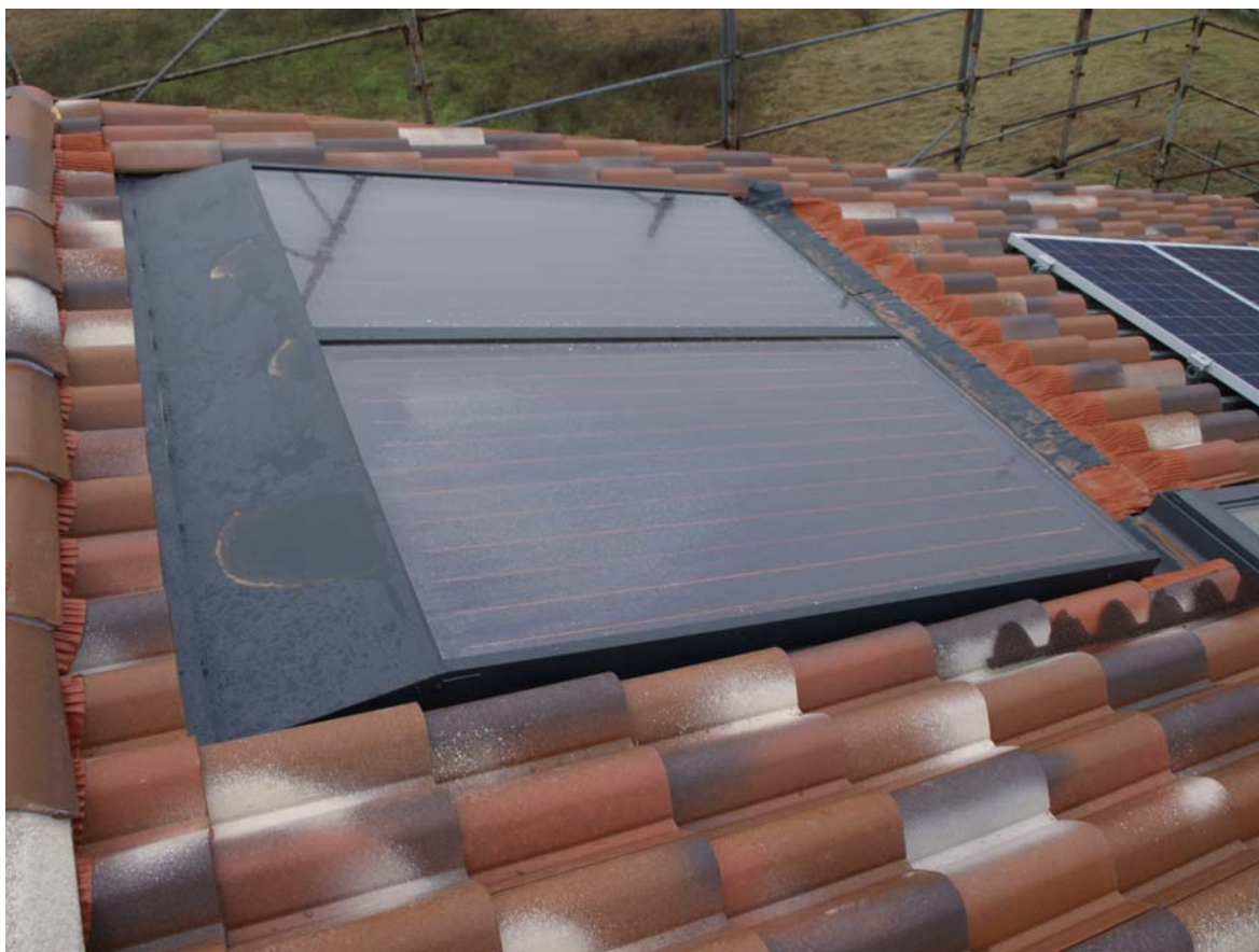
Solare termico per produzione acqua calda sanitaria
