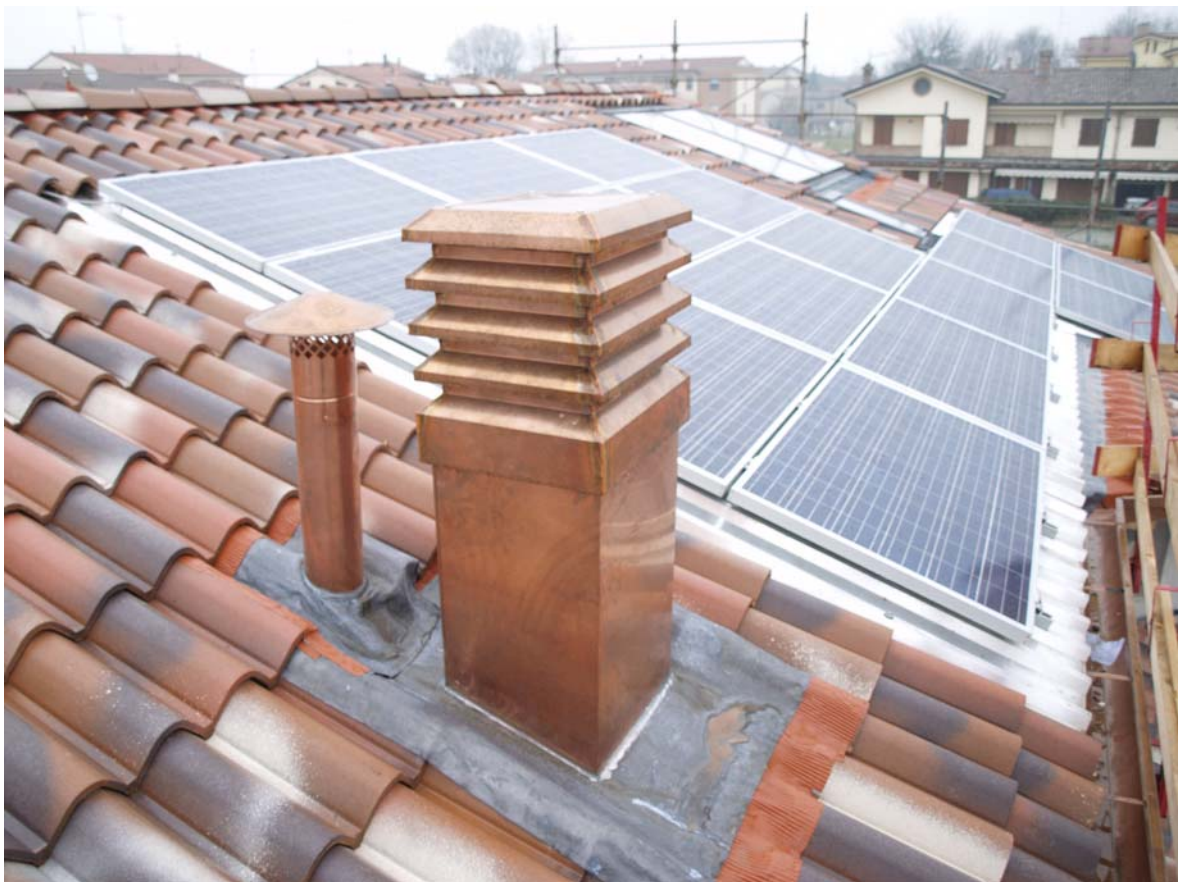
Pannelli fotovoltaici integrati nella copertura
