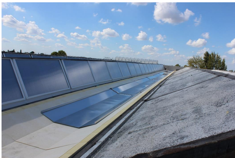
Fasi di realizzazione dell'isolamento termico di una copertura industriale con POLIISO su misura
